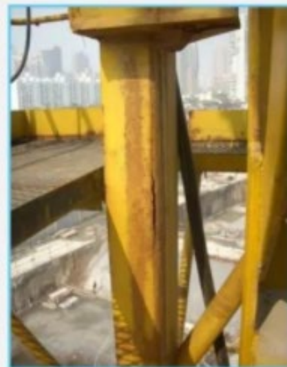
立柱结构件裂缝
